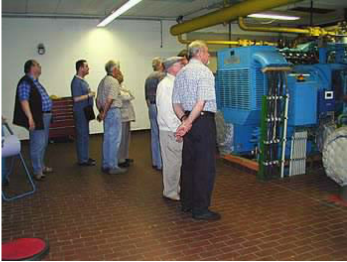
Die Generatoren werden von riesigen Motoren angetrieben, die auf Gasbetrieb eingestellt sind.
