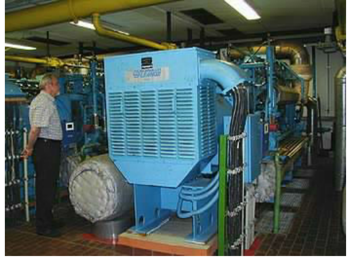
Die von den Motoren erzeugte Wärme wird mit zum Betrieb des Heizwerkes genutzt.
