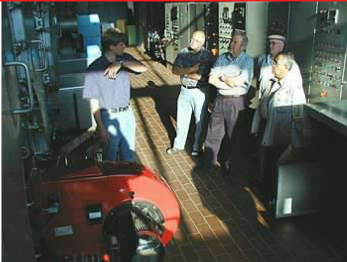
Karsten Eisfelder zeigte uns zunächst das Kesselhaus des Heizwerkes.
