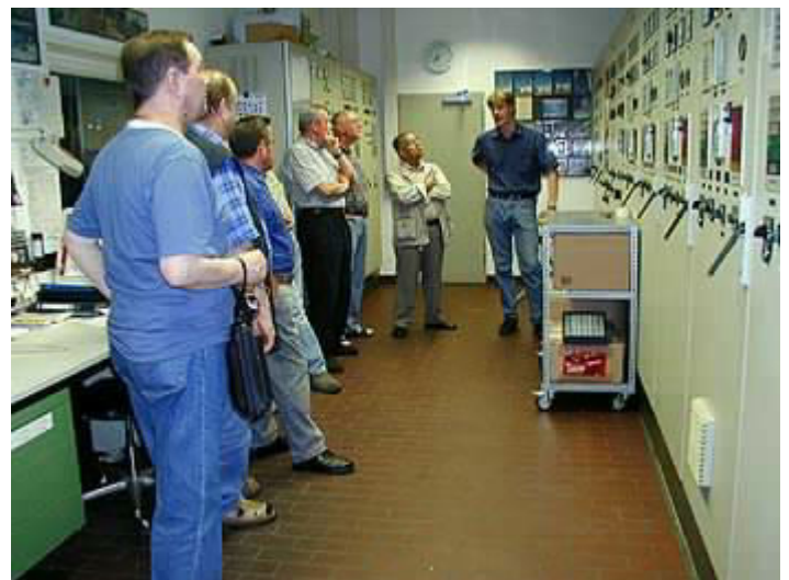
Der Überwachungsstand für die Blockheizkraftwerksgeneratoren.
