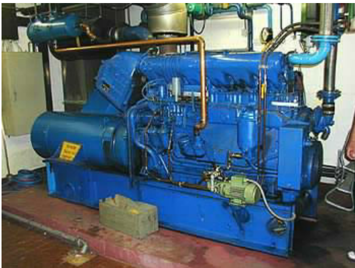
Ein Dieselgenerator zur Notstromerzeugung.
