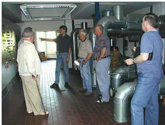
Die Übergabestation, hier wird die abgegebene Wärme für die Abrechnung registriert.
