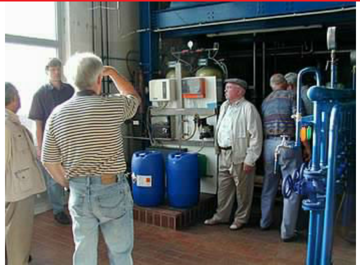
Hier kann mit drei großen Heizkesseln Fernwärme erzeugt werden.
